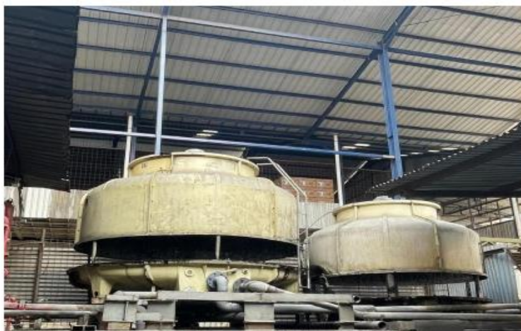
Gambar 4. Cooling tower A dan B
