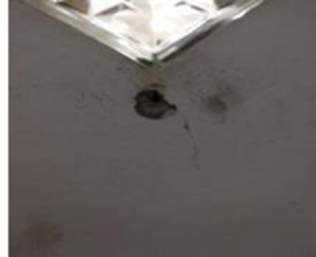
Gambar 2. Kerusakan pada Dinding Kamar Sumber: Hasil Observasi Lapangan
