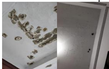
Gambar 3: Kerusakan Pada Plafon Lantai 2 & Lantai 3 Sumber : Hasil Observasi Lapangan
