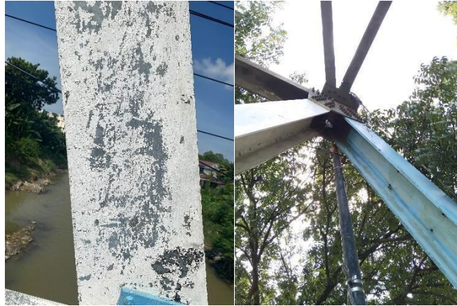
Gambar 5. Kerusakan Rangka Baja Jembatan
