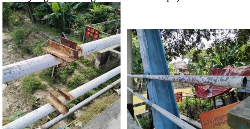
Gambar 3. Kerusakan Railing Jembatan
