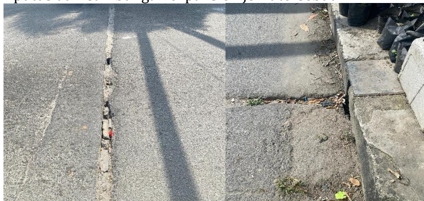
Gambar 4. Kerusakan Lantai Jembatan
